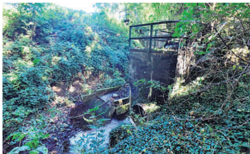
Das Stauwerk verfällt und soll abgerissen werden.
